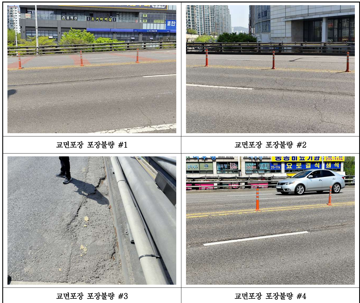
【사진 3.33】 교량의 공중이용시설 10대 위험요소 손상현황
